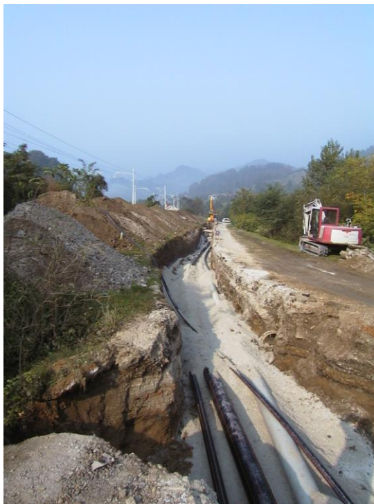
***** Slika: Kolektor.jpg ***** ***** Tekst: Izgradnja transportnega kolektorja Laško – čistilna naprava poteka v skladu z načrti.
