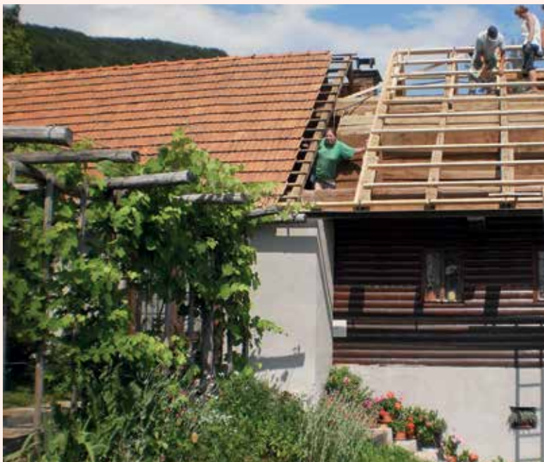
Po požaru je streha na hiši kar klicala po obnovi.
