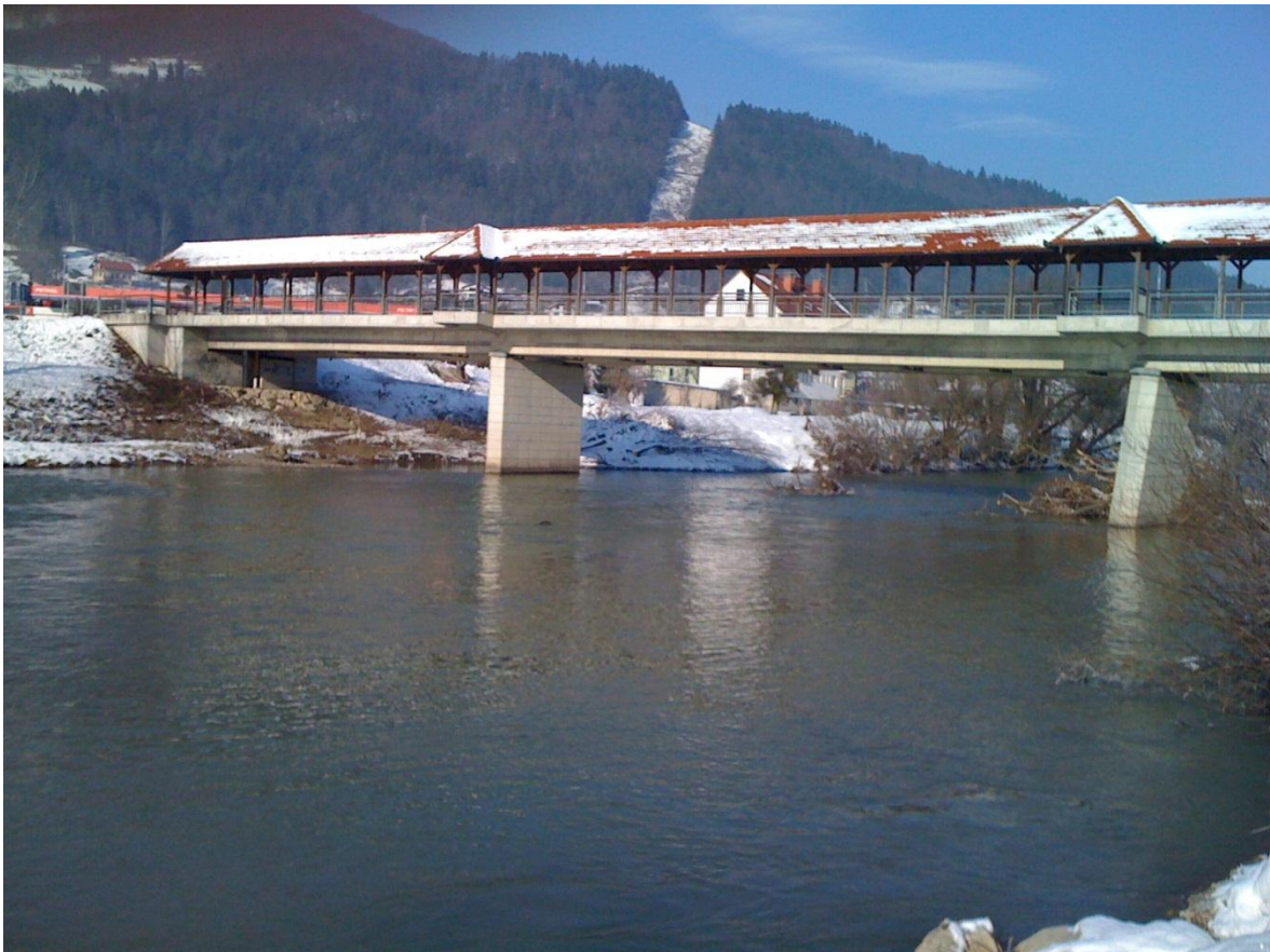
Slika: Poškodovani most v Jagoče
