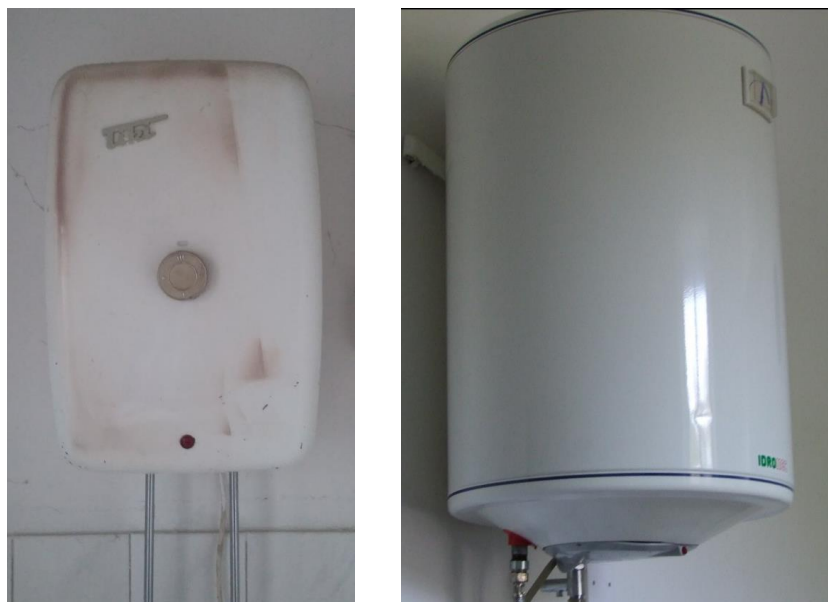
Slika 3: Bojlerja za toplo sanitarno vodo
