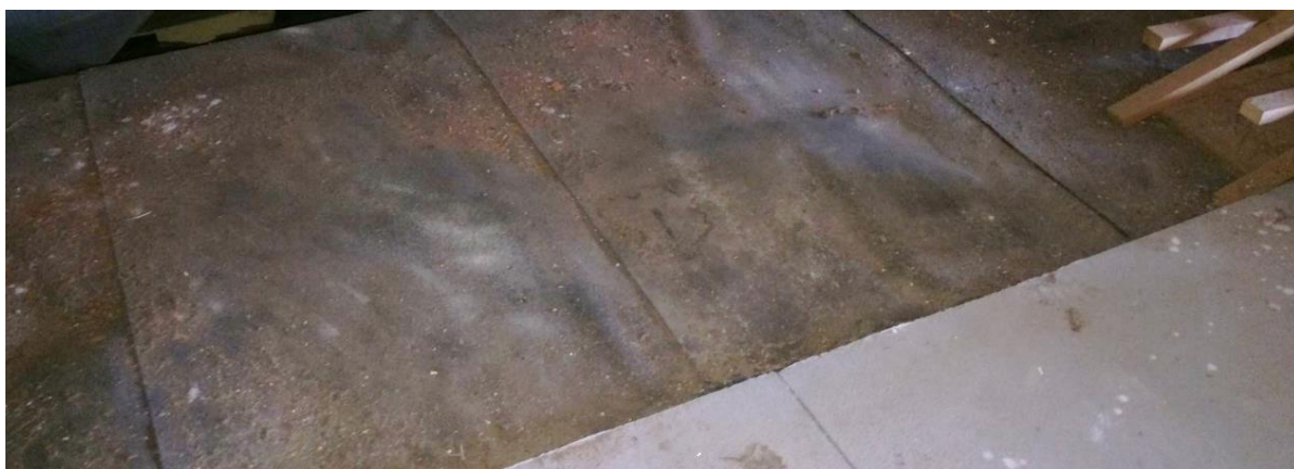
Slika 7: Neizolirani strop proti hladnemu podstrešju
