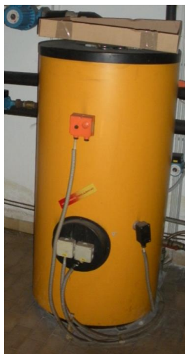
Slika 4: Boiler za toplo sanitarno vodo v kotlovnici
