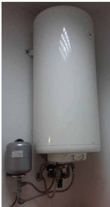
Slika 3: Bojler za toplo sanitarno vodo
