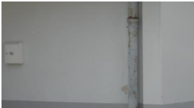
Slika 4: Neizolirani zidovi stavbe
