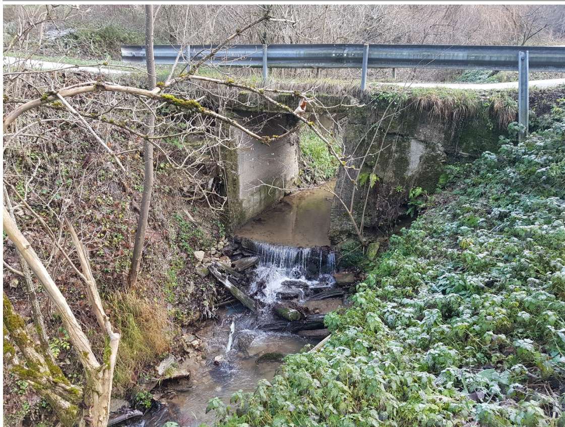
Slika 2: Pogled na dotrajan most z dolvodne strani.
