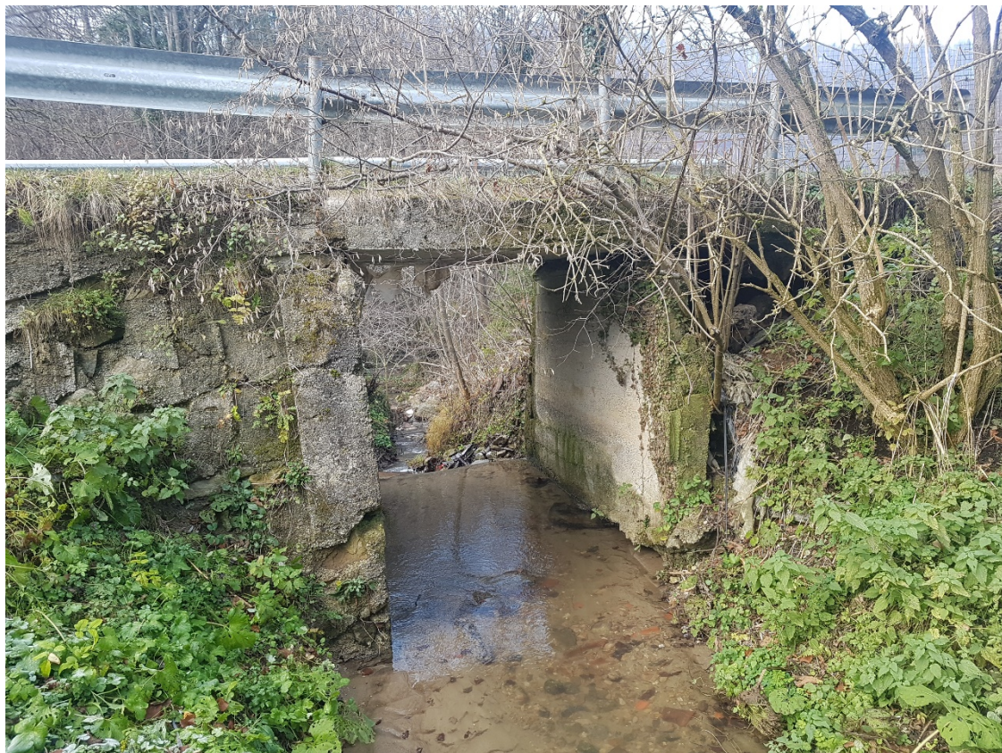
Slika 1: Pogled na dotrajan most na javni poti JP700761 z gorvodne strani
